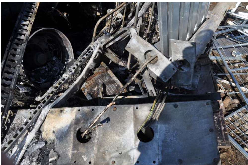
Foto 5 Dele af overkørselsanlægget efter påkørsel og brand
